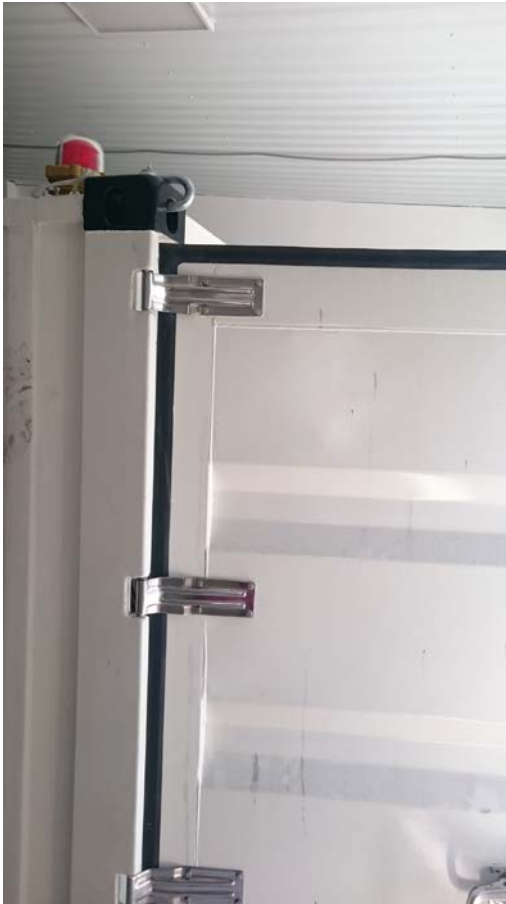
Сигнальная лампа при проведении высоковольтных испытаний
