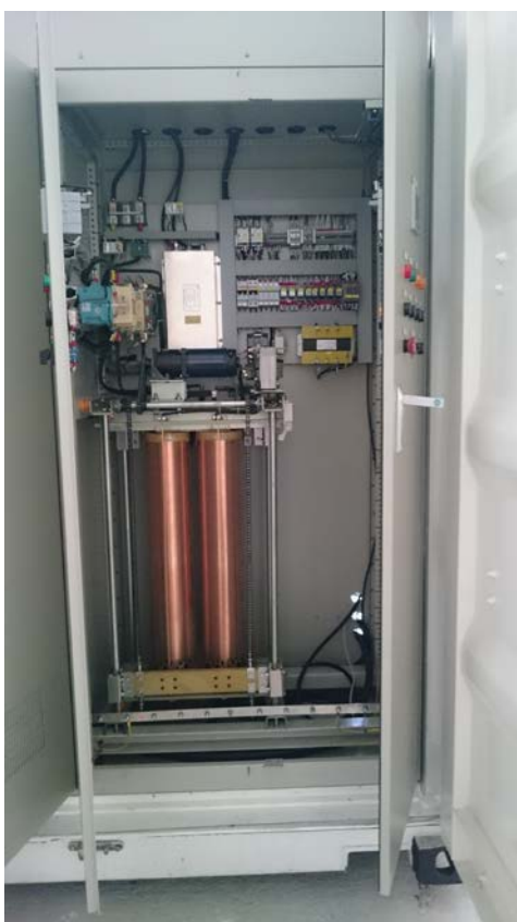
Шкаф регулятора напряжения автотрансформаторного с защитами от КЗ и перенапряжений АВВ
