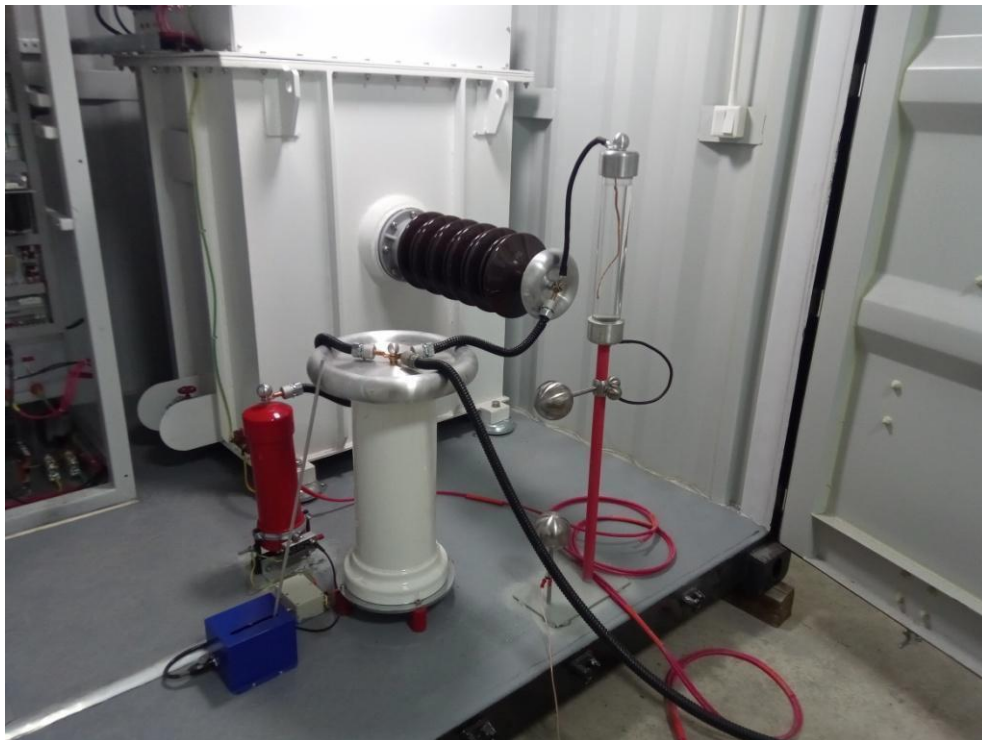
Высоковольтный отсек с резонансным реактором, резонансным конденсатором, делителем напряжения, шаровым разрядником, токоограничивающим резистором, заземлителем высоковольтного выхода электромеханическим.
