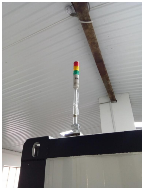
Сигнальная мачта при проведении высоковольтных испытаний (световая и звуковая сигнализация)
