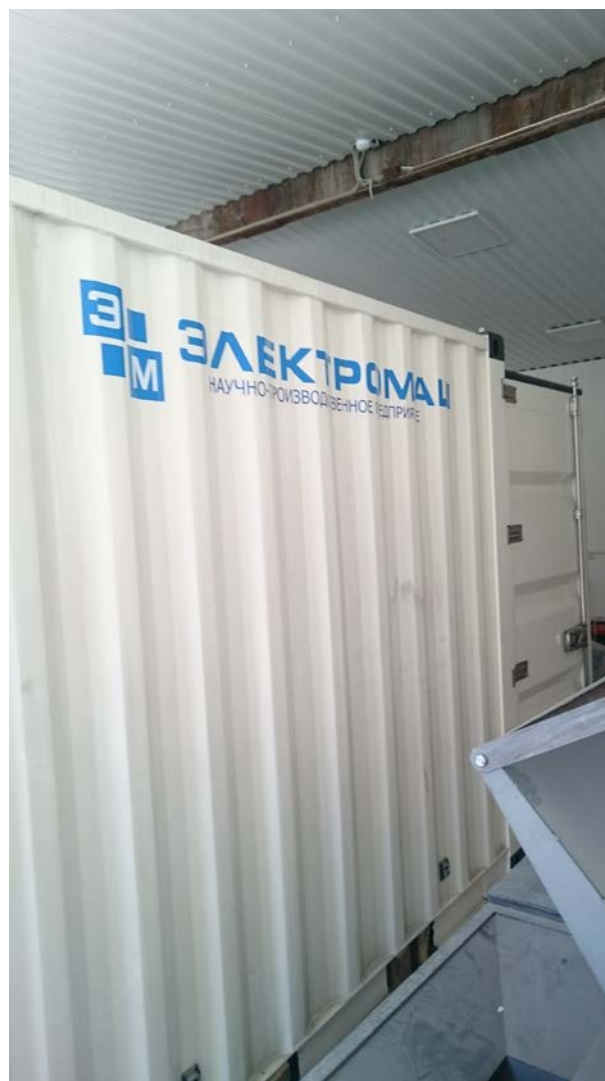
Вид сбоку корпуса- контейнера
