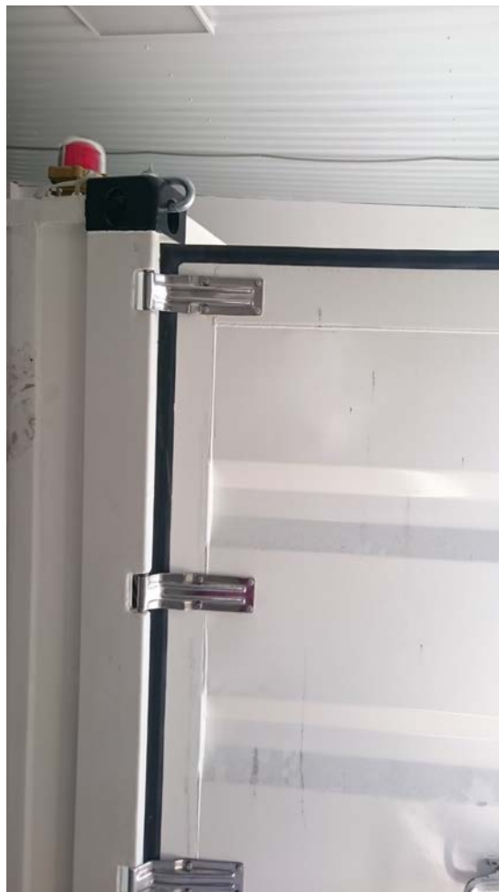
Сигнальная лампа при проведении высоковольтных испытаний
