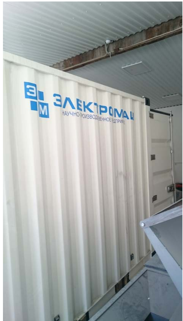
Вид сбоку корпуса- контейнера
