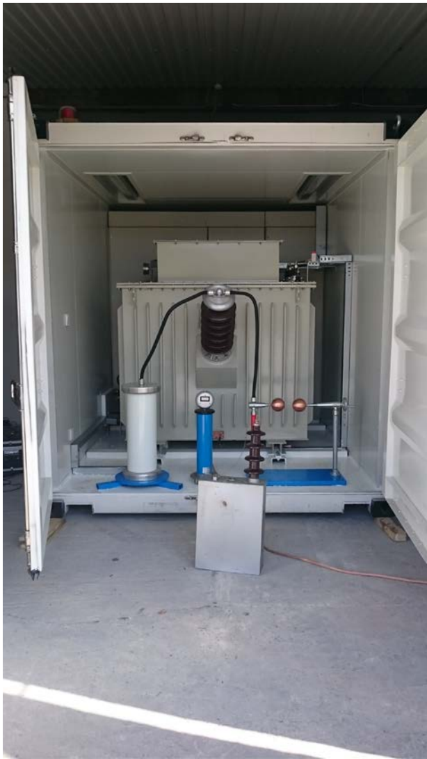
Высоковольтный отсек с резонансным трансформатором, делителем напряжения, шаровым разрядником и блоком выпрямленного напряжения
